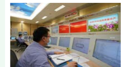
辽宁红沿河核电站 5 号机组投运瞬间
