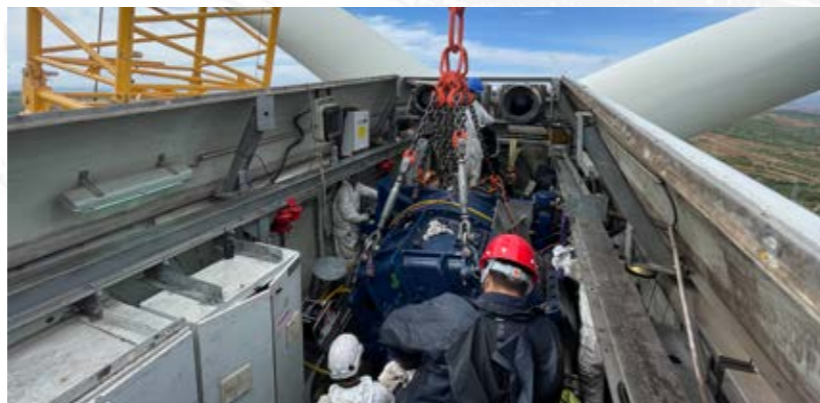
→ 在辽宁长皋风电场，完成国内采用 GE2MW 齿轮箱的先例，解决机组长停问题，抢发电量 100 万千瓦时
