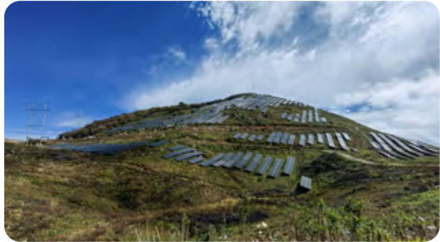
中广核重庆城口咸宜光伏项目一期
